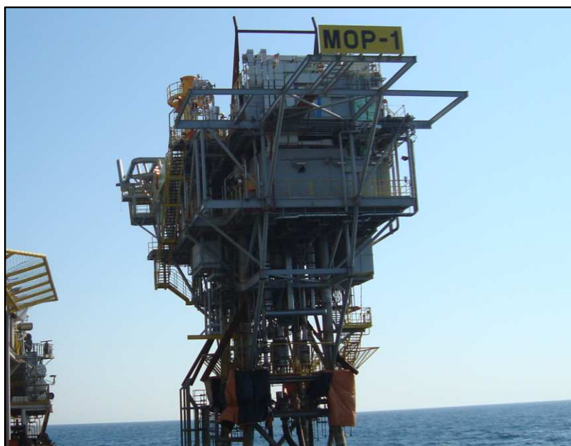
Figura 6 . Módulo de Operação de Pigs (MOP-1), da Petrobras. Retirado de <www.promonengenharia.com.br> (Acesso em 26 mai. 2013, 16:20:00).
